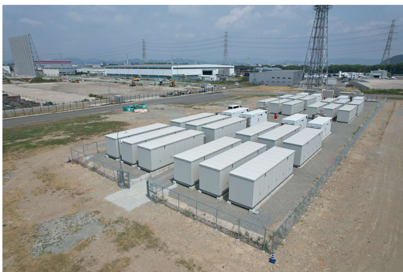
(姫路蓄電所／2025年8月撮影)
